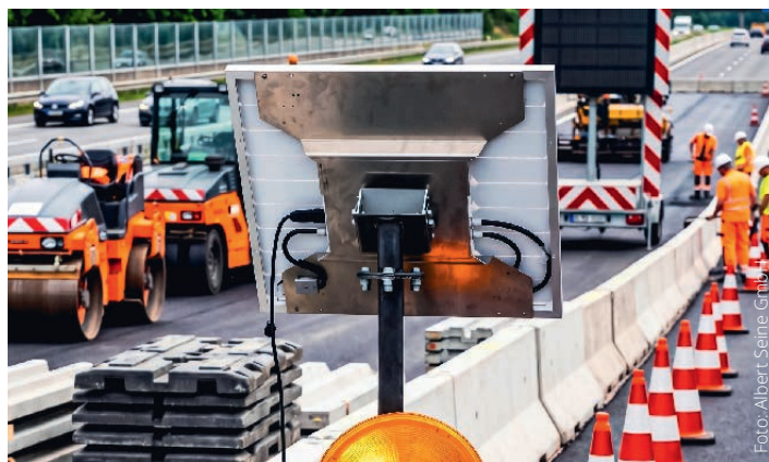
Auf Baustellen wird häufig eine autarke Energieversorgung benötigt. Die Albert Seine GmbH hat eine Kombination von Energiebox und PV-Modul entwickelt, die die Energie optimal verwertet und bei Defekten leicht auszutauschen ist, heißt es.
